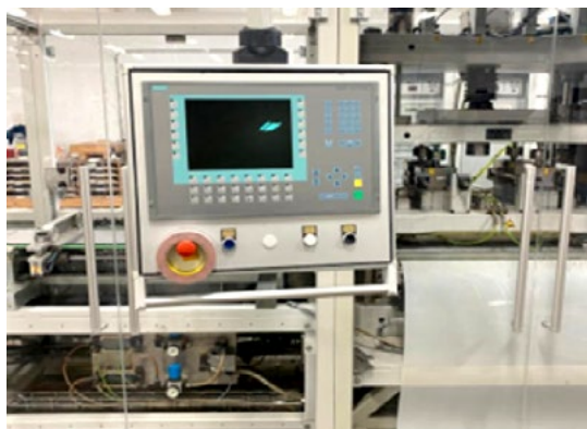
Figura 1. Tablero de control (de 9 PLC). Fotografía cortesía de Gabriel Rihan de SAMSILL de Mexico S.A de C.V.
